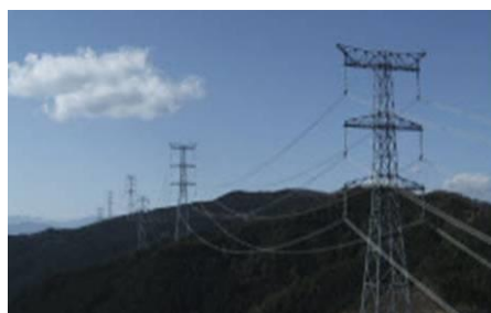
UHV 送電線 (写真: 東京電力)
